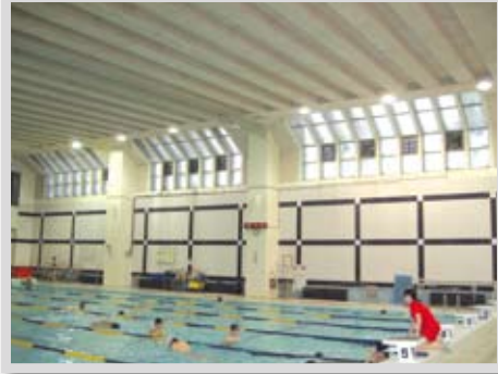
中期室內溫水游泳池 提供溫水、冷氣、排風系統
