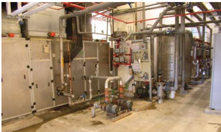
多功能熱回收主機系統
